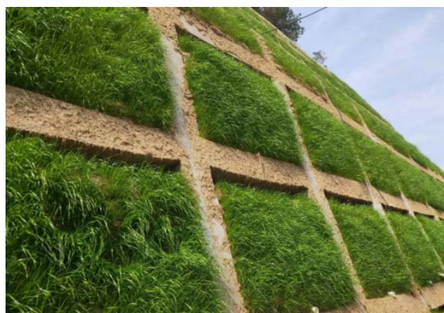
图2某市矿山生态修复团粒客土喷播项目
