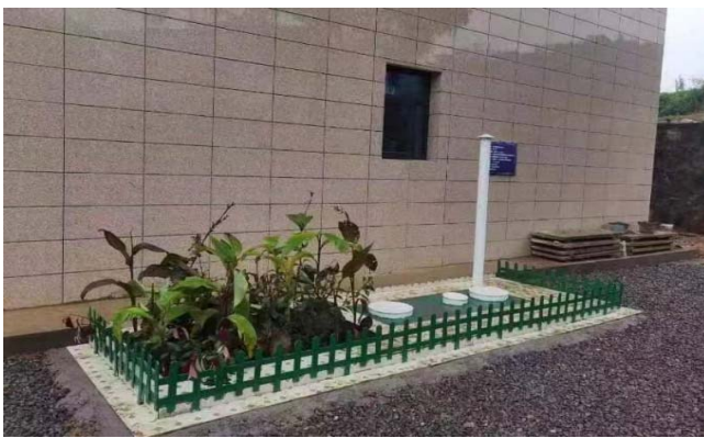
图6 一体化污水处理设施与微动力污水处理设施
